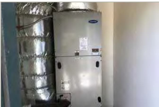
5 – FAN COIL UNIT
